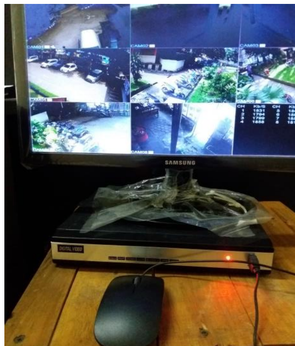
Layar monitor CCTV
