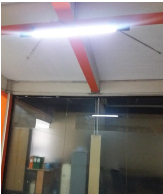
Penerangan di lobby lingkungan kerja
