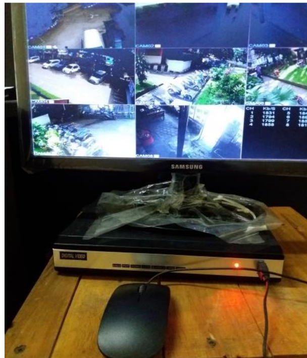
Layar monitor CCTV
