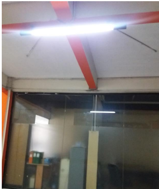
Penerangan di lobby lingkungan kerja
